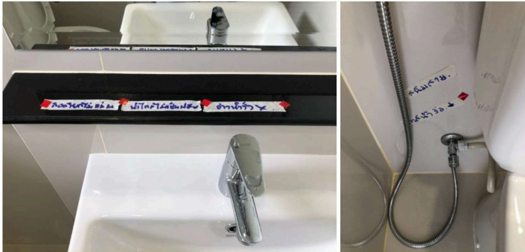
เก็บงาน ก๊อก โยกไม่แน่น น้ำไหลไม่เป็นฝอย อ่างน้ำรั่ว เก็บงาน สนิม สาย วาล์วน้ำรั่ว
