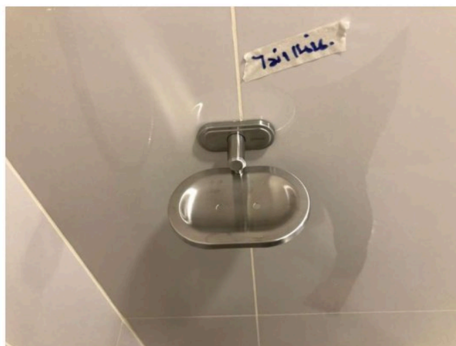
เก็บงาน ติดตั้งโยกไม่แน่น
