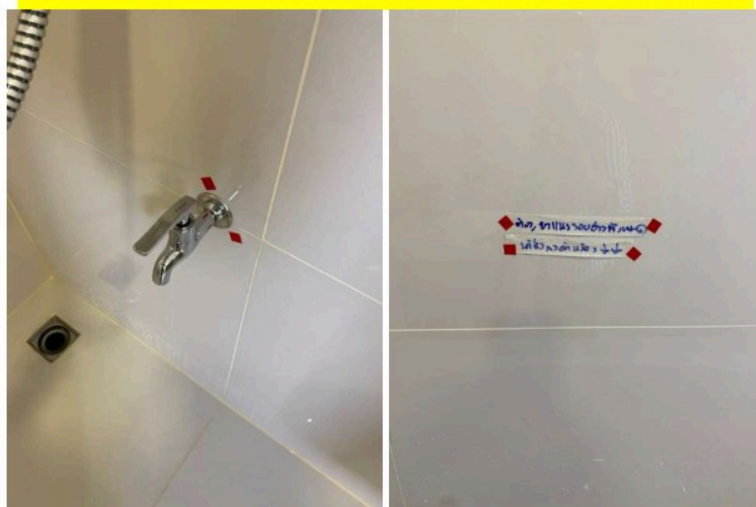
เก็บงานยาแนว เก็บงานยาแนวรอบอ่างอาบน้ำ น้ำรั่วลงด้านล่าง
