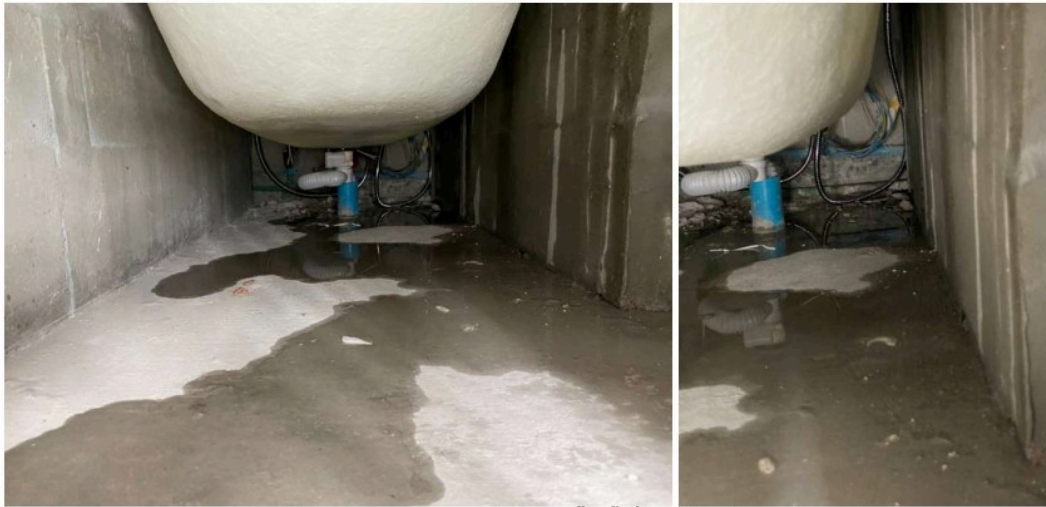
เก็บงานยาแนวรอบอ่างอาบน้ำ น้ำรั่วลงด้านล่าง
