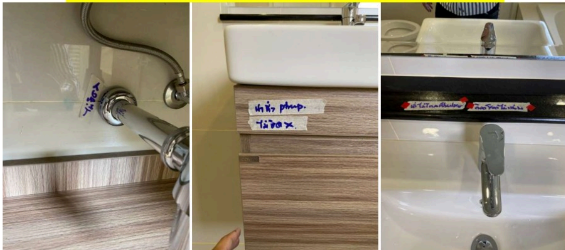
เก็บงานฝาดิจ ไม่ขัด เก็บงานก๊อกน้ำไหลไม่เป็นฝอย เก็บงานก๊อกโยกไม่แน่น
