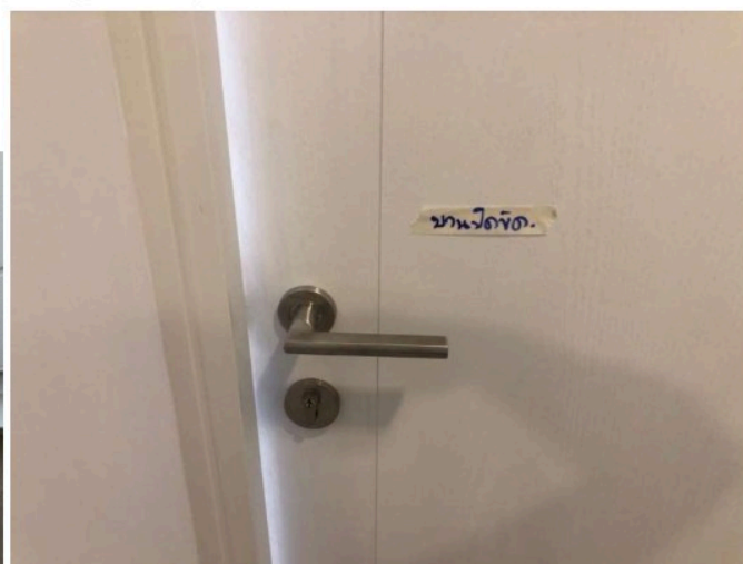
เก็บงานพื้นยวบ บานปิดขัด
