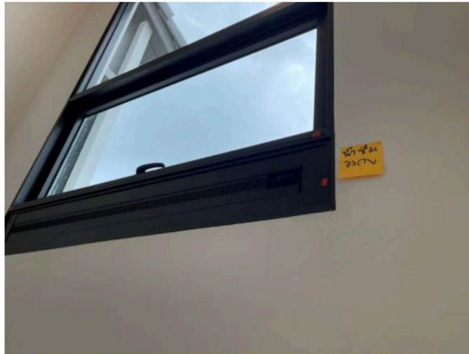
เก็บงาน น้ำซึมวงกบ และ รอยต่อเฟรมบานไม้ชิดกันช่องว่าง
