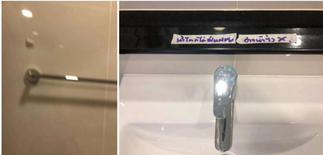
เก็บงาน กระเบื้องเป็นรอย น้ำไหลไม่เป็นฝอย อ่างน้ำรั่ว
