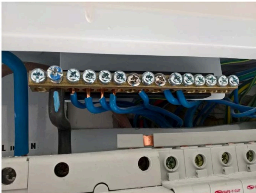
รูปที่ 100 การเชื่อมต่อสายนิวทรัล (Neutron Line) ครบจำนวน และถูกต้อง
